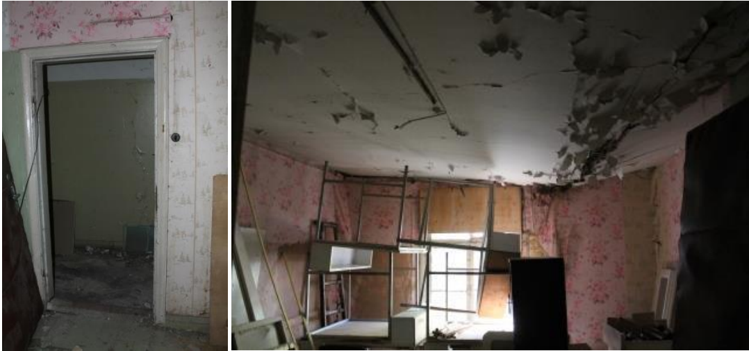
Fotod 40 ja 41. Vaade ruumile 14. Säilinud algne ukseliist. Ruumi lagi on sisse vajumas.
